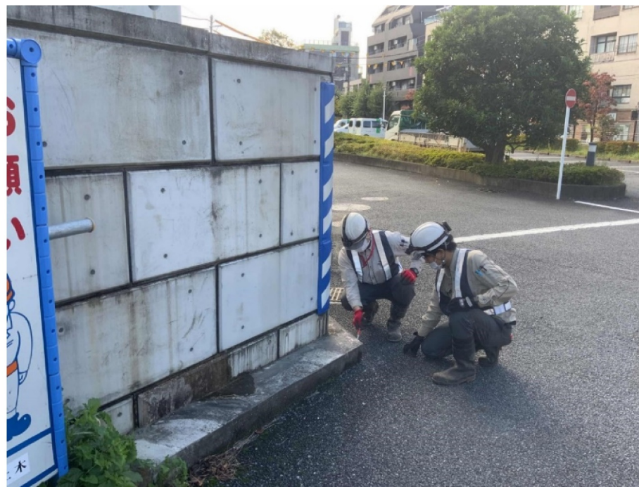
路面変状監視
