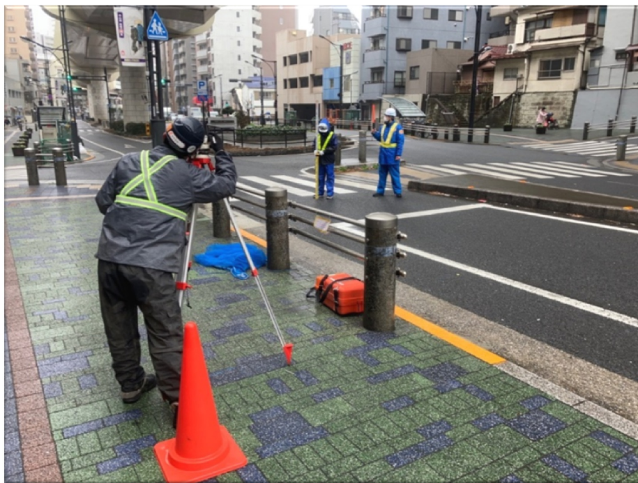
路面変状計測
