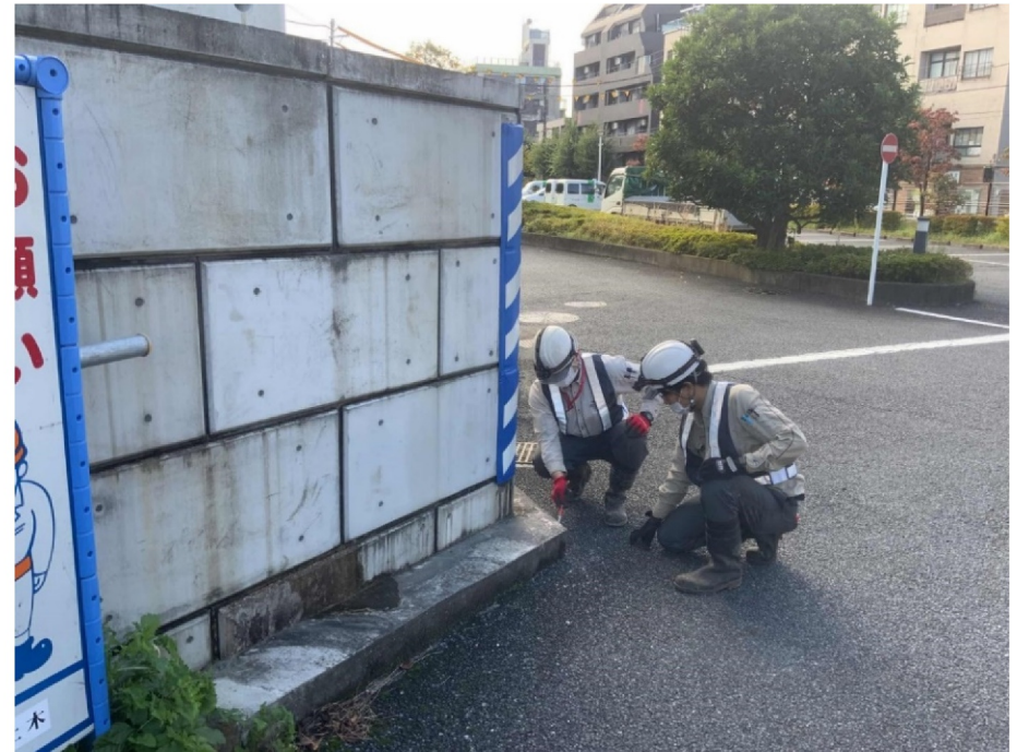
路面変状監視
