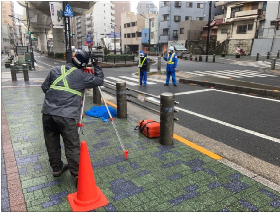
路面変状計測
